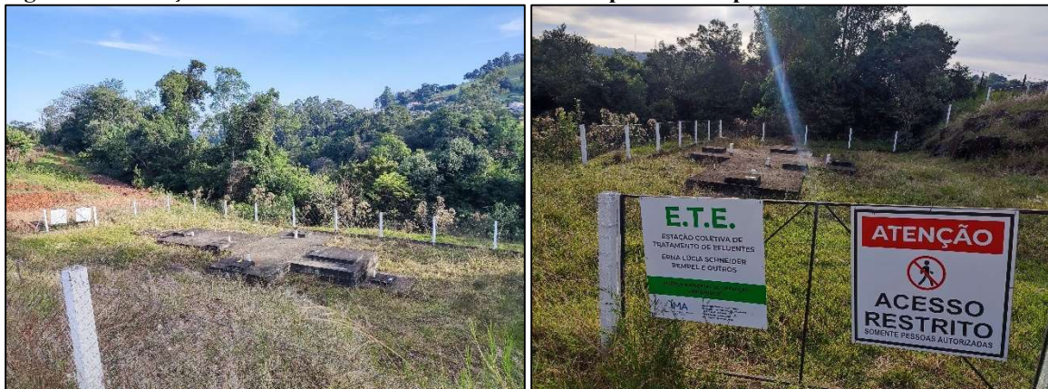
Figura 41 – Estação de Tratamento de Efluentes no município de Tunápolis.
