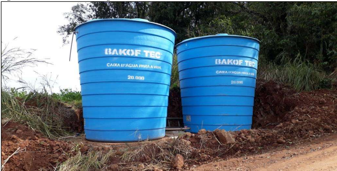
Figura 51 – Reservatório São Miguel.
