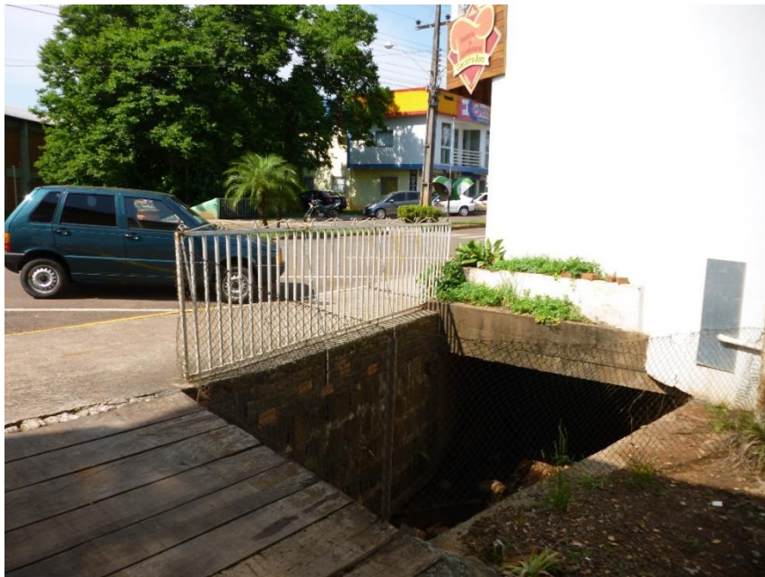
Figura 70. Ponto onde a canalização do rio está exposta e representação do ponto 22 da Figura 69, localizado na Avenida Cerro Largo.
