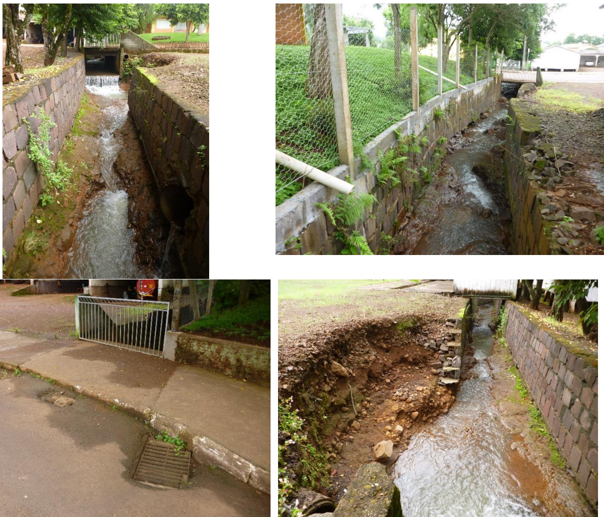
Figura 79. Trecho de rio canalizado iniciando próximo ao Clube dos Idosos na Rua Padre Balduino Ramo.
