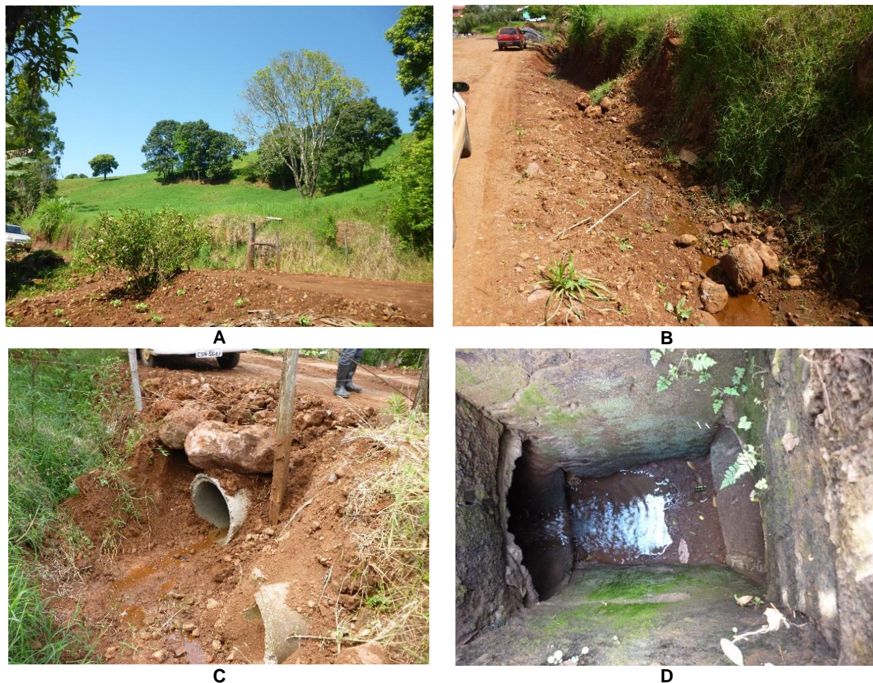
Figura 82. (A) Uso do solo à montante do início da retificação e canalização do rio. (B) Canal de drenagem do manancial superficial, localizado nas proximidades do cemitério, ao lado do viveiro municipal. (C) Início da retificação do manancial superficial por meio de manilhamento. (D) Caixa de passagem da manilha de drenagem na Rua Santa Cruz.
