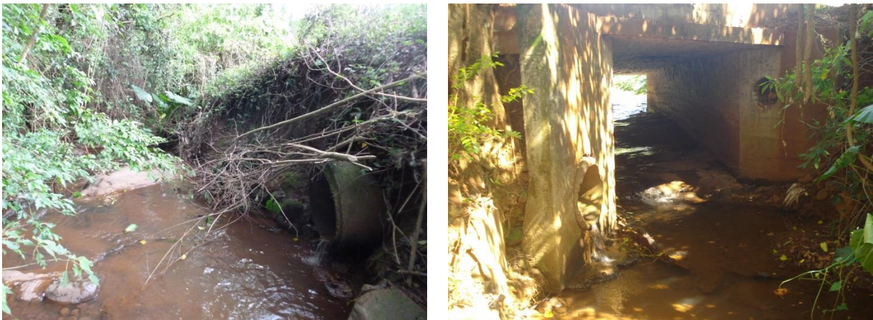
Figura 27. Pontos de lançamento de macrodrenagem com indícios de ligação clandestina de esgoto.
