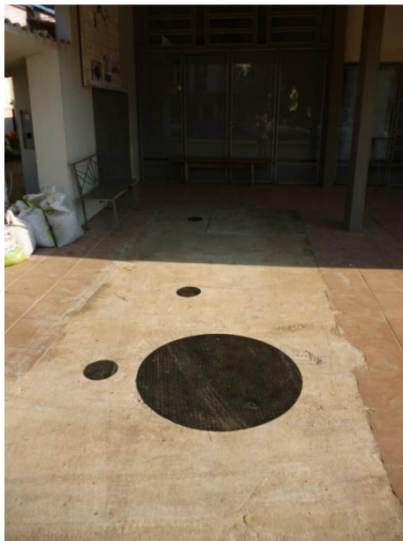
Figura 26. Sistema individual de filtro anaeróbio e caixa de cloro utilizados para tratamento do esgoto gerado em uma padaria localizada na Av. Serro Largo.
